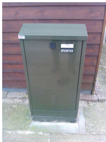
- Kabelskab som post
